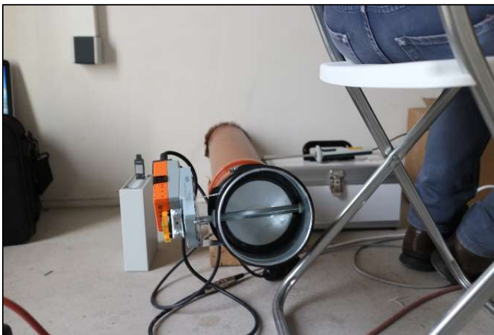
Abbildung 11: Innenansicht auf Zuluftröhr
