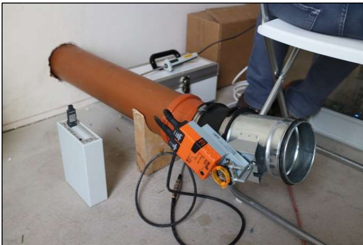
Abbildung 10: Innenansicht auf Zuluftröhr
