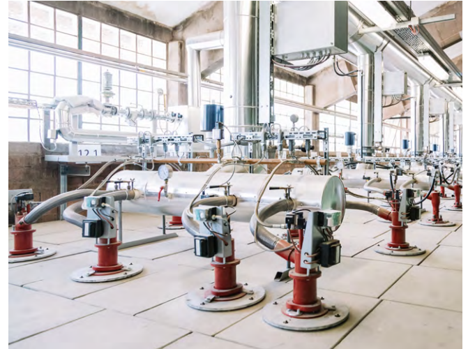
Abbildung 32: Brenner auf einem Tunnelofen; Quelle: LEIPFINGER-BADER GmbH
