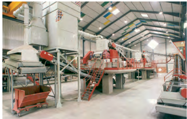
Bild 7.148. Aufbereitungsanlage mit Kollergang Quadro, Vorwalzwerk und Schwingenwalzwerk Alpha, 1997
