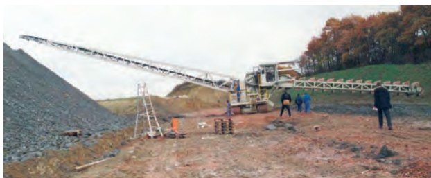
Bild 6.34. Lasergesteuerter Eimerkettenbagger auf Raupen, mit Förderband zum Aufschütten des gebaggerten Materials auf Halde, von Petersen/Dänemark, 1996
