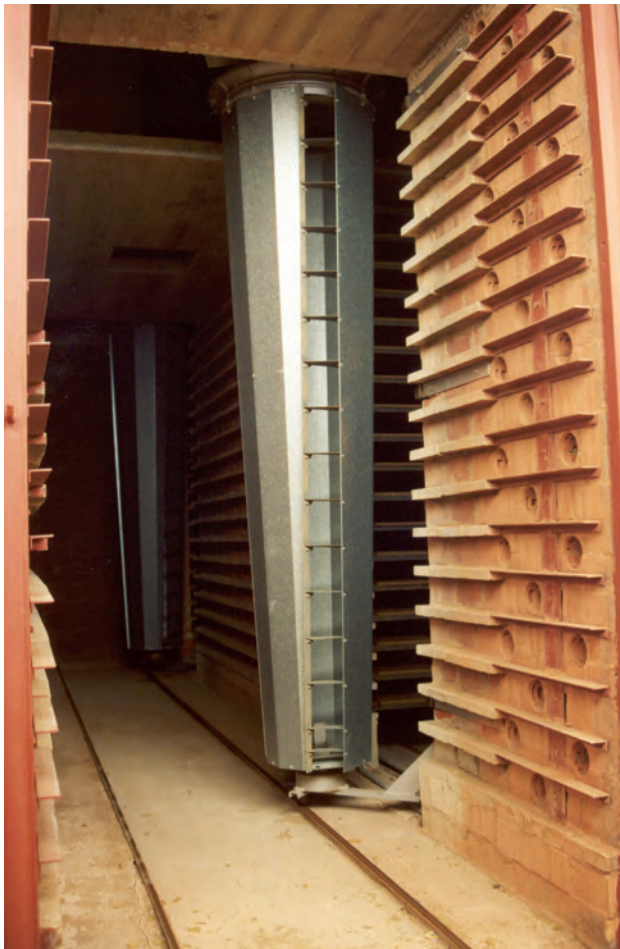
Bild 9.68. Blick in eine Trockenkammer mit Drehlüfter
