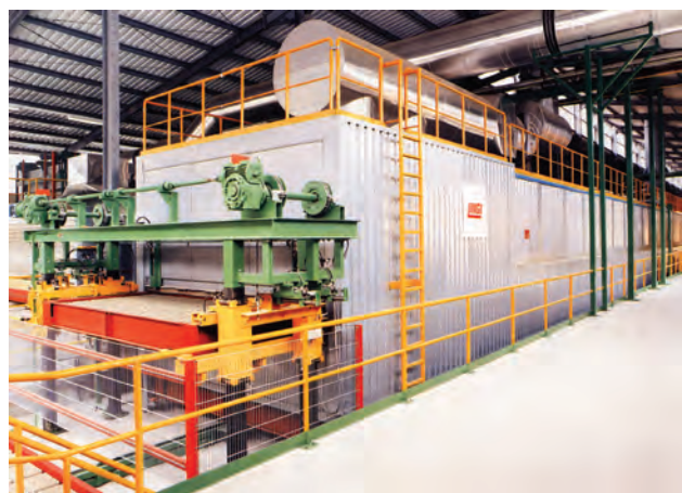
Bild 9.81. Kasettentrockner, Blick auf die Kassettenrückführung
