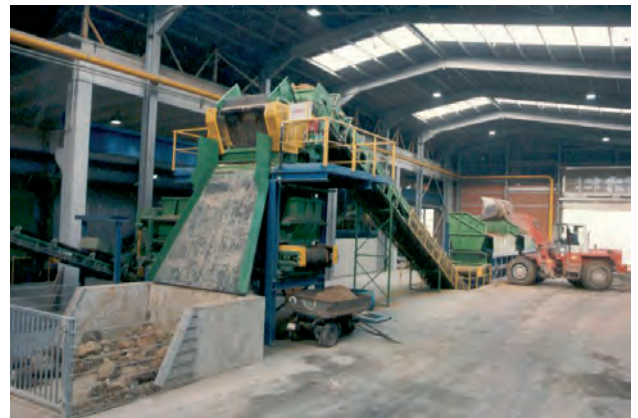
Bild 7.109. Steinaussonderungsrechen in einer Aufbereitungsanlage, 1994
