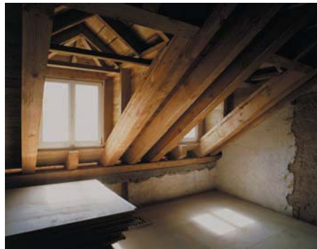
Abb. 1: Kommt es zu Feuchteschäden am geneigten Dach, ist der Dachdecker in der Regel der erste Ansprechpartner. Dies spricht für Dachdeckung und Dachausbau aus einer Hand.
