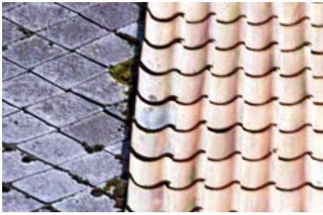
Friedlich vereint auf einer Dachfläche: links Asbestzementplatten als tickende Zeitbombe, rechts umweltunbedenklich: Dachziegel (Foto: AZD)
