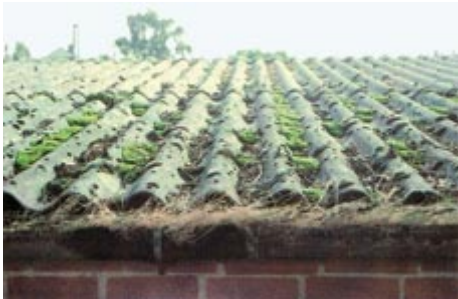
In die Jahre gekommenes Wellasbestdach (Foto: Schäffner, „Handbuch der Gebäudeschadstoffe für Architekten, Sachverständige und Behörden“)
