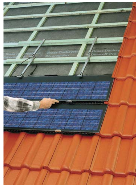
Abb. 10: Solarstrom-Indachsysteme wandeln Sonnenenergie in elektrischen Strom um, geräuschlos, emissionsfrei und ohne belastende Rückstände.
